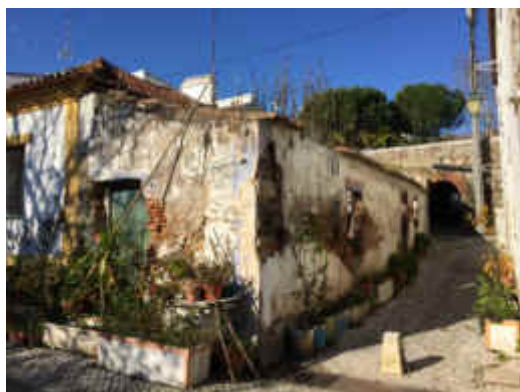
Figura 28. Exemplos de edificações em mau estado de conservação
