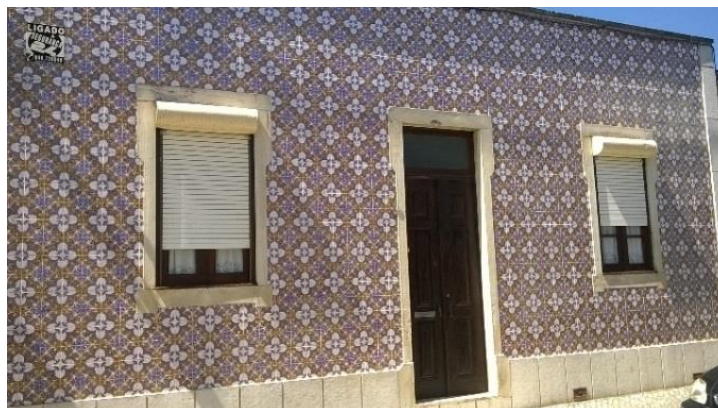
Figura 12. Exemplo de edifícios desenquadrados que deverão ser reabilitados
