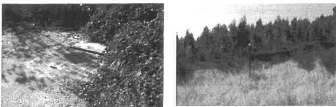
Figura 1.2 – (a) Local do reservatório para recolha de lixiviados e (b) tubo de ventilação do biogás na lixeira encerrada de Vila Nova da Barquinha (Fonte: CTIC, 2014)
