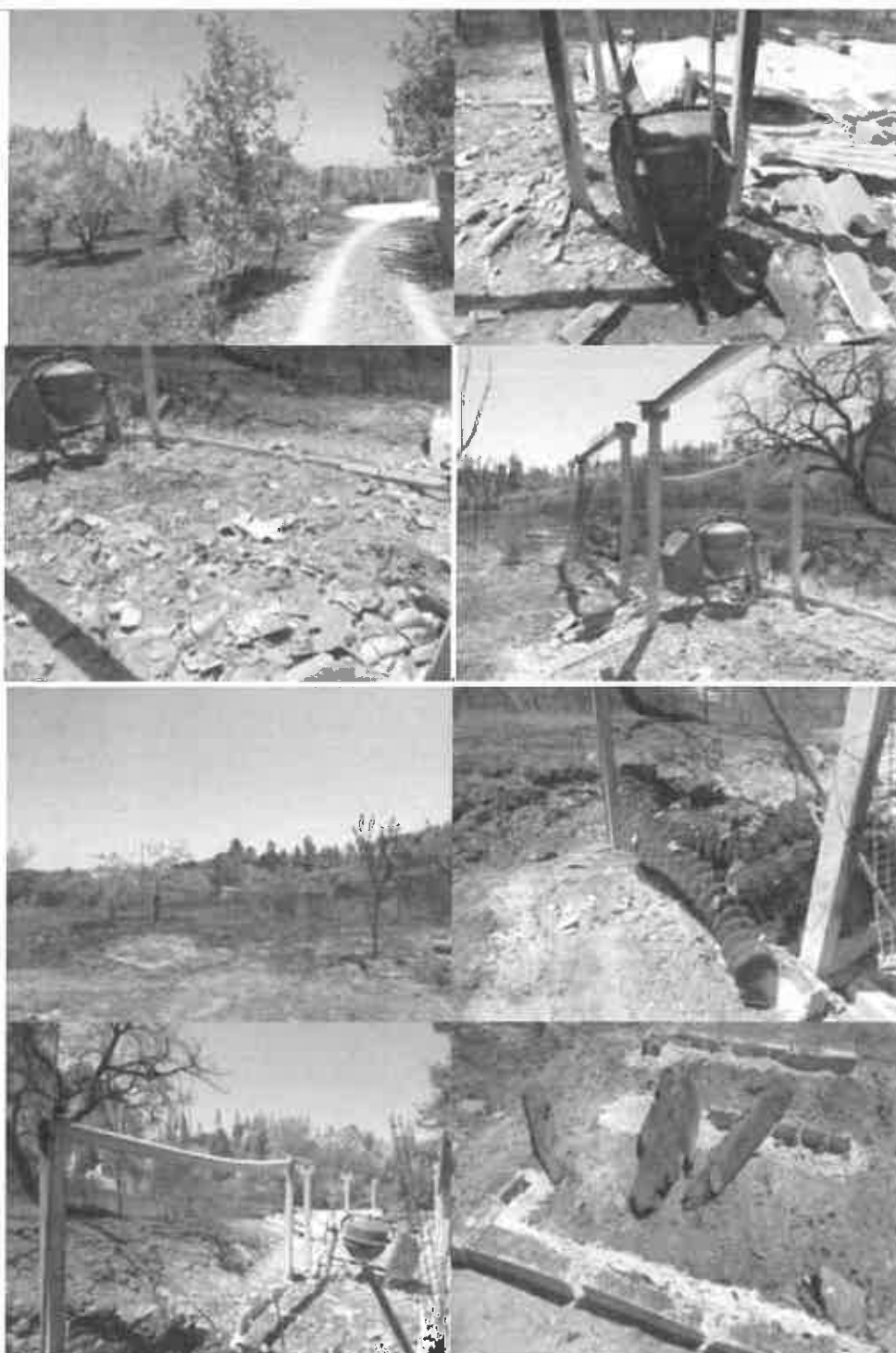
Pormenor da viga de cimento; o bloco de cimento desfeito indiciando temperatura do fogo acima de 800°C
