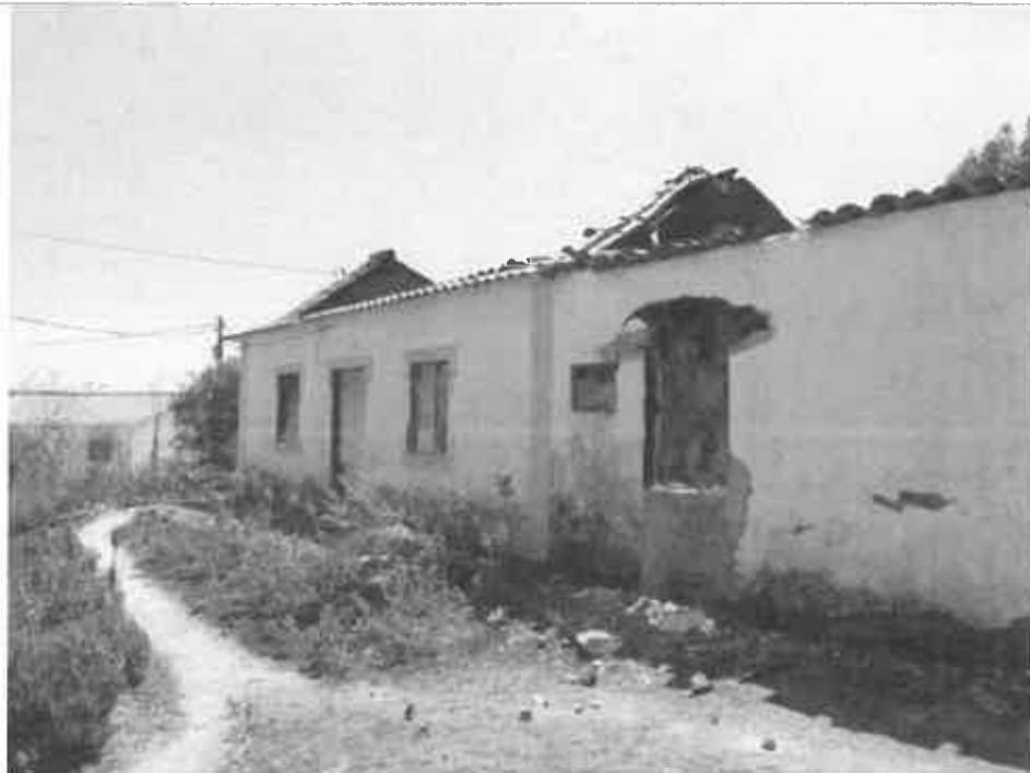
Habitação após incêndio de 07-07-2015
